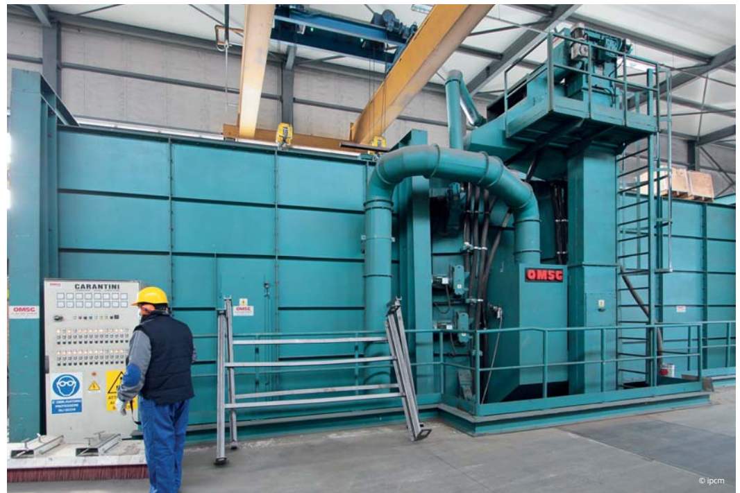
La granigliatrice a tunnel modello Tunnelblast 2530/16 installata da OMSG.
